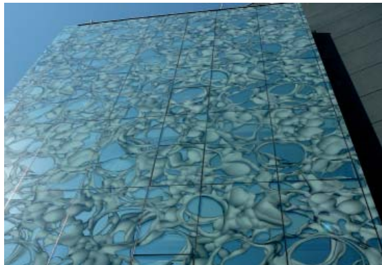
La décoration artistique de cette façade réduit fortement le risque de collision.
