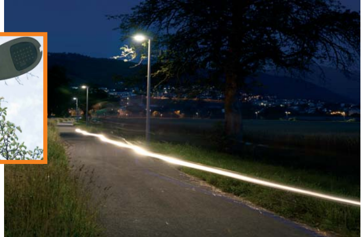
Un chemin pour piétons et vélos équipé des luminaires les plus modernes couplés à des détecteurs de mouvement. La lumière devient plus intense au passage d'un cycliste.
